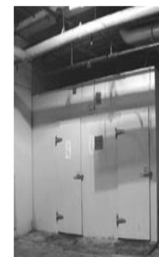
圖 10-21 垃圾冷藏設備
